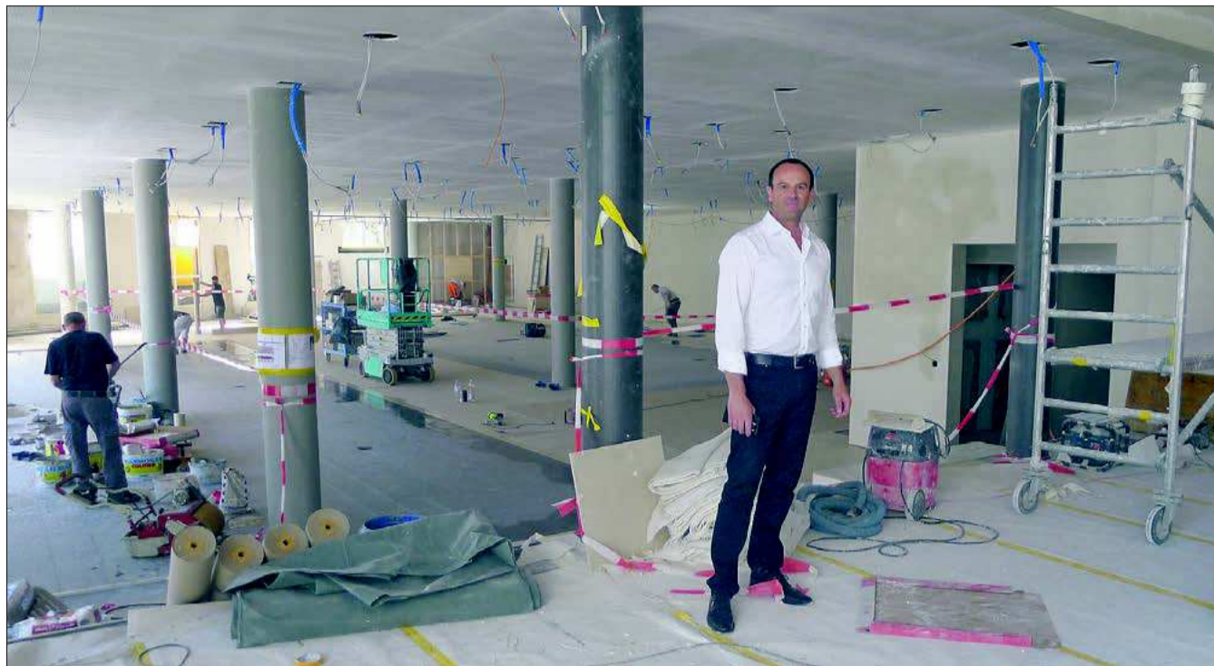
Unternehmer Hansruedi Röschmann setzt beim Umbau seines Showrooms auf die Kompetenz des einheimischen Gewerbes.
